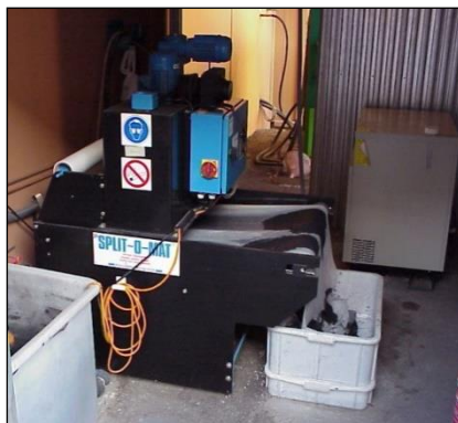
Depuradora por floculación
