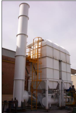
Termoreactor: equipo de depuración de emisiones de COV's por oxidación térmica regenerativa.
